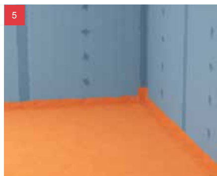
5 Celoplošné utesnenie povrchu v oblasti W1-I.
